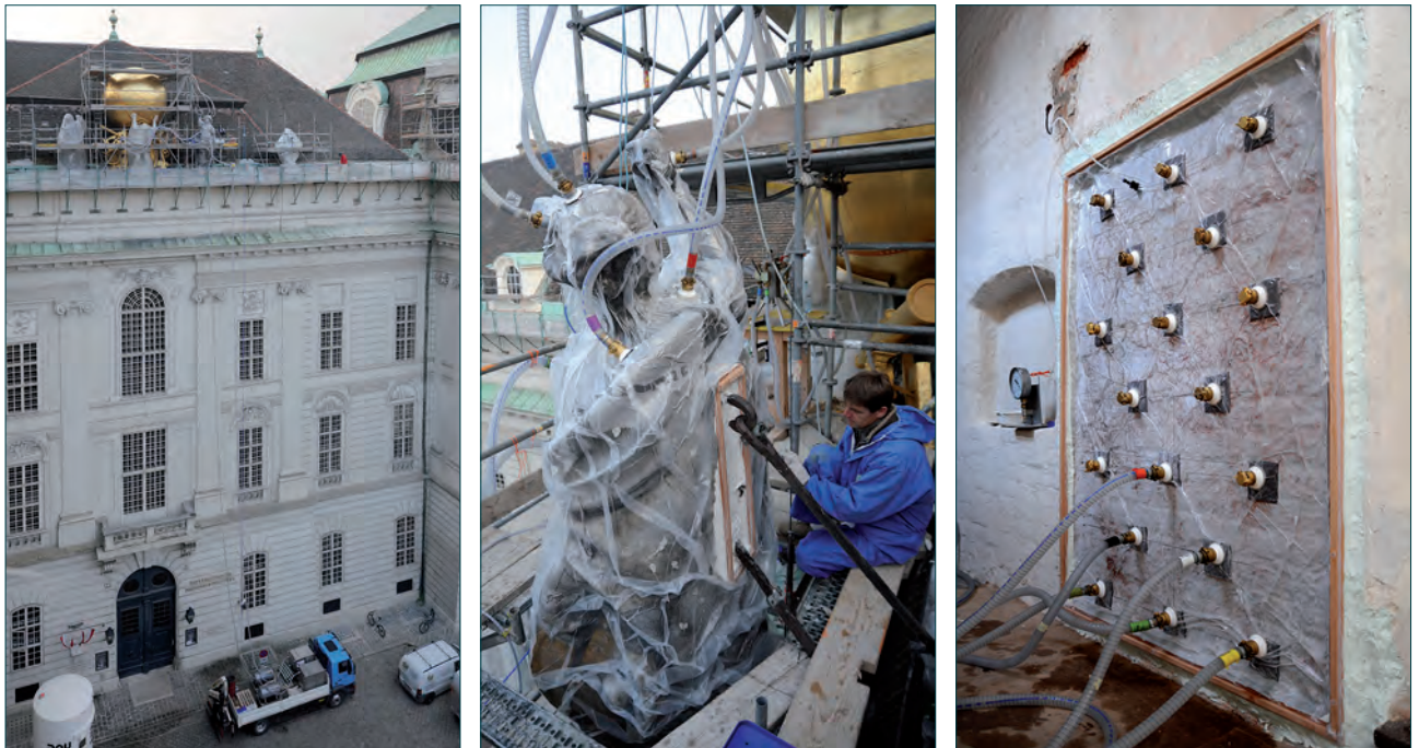
Abb. 84 In-situ Festigung einer 3 m großen Attika-Figur auf der Nationalbibliothek/Hofburg Wien, die zur Konservierung nicht entfernt werden konnte. Zwei Geräte, jeweils auf dem LKW und an der Skulptur wurden gekoppelt und es wurde eine Höhe von 30 m überwunden (erstes und zweites Foto). Entzaltung einer Ziegelmauer im Johanniskloster in Stralsund (rechtes Foto, Fotos: Erich Pummer).
