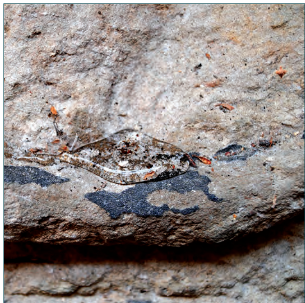
Abb. 96 Resthydrophobie auf der Oberfläche des Grabmals: Wasser „perlt“ auf der Steinoberfläche ab (nach VKV).
